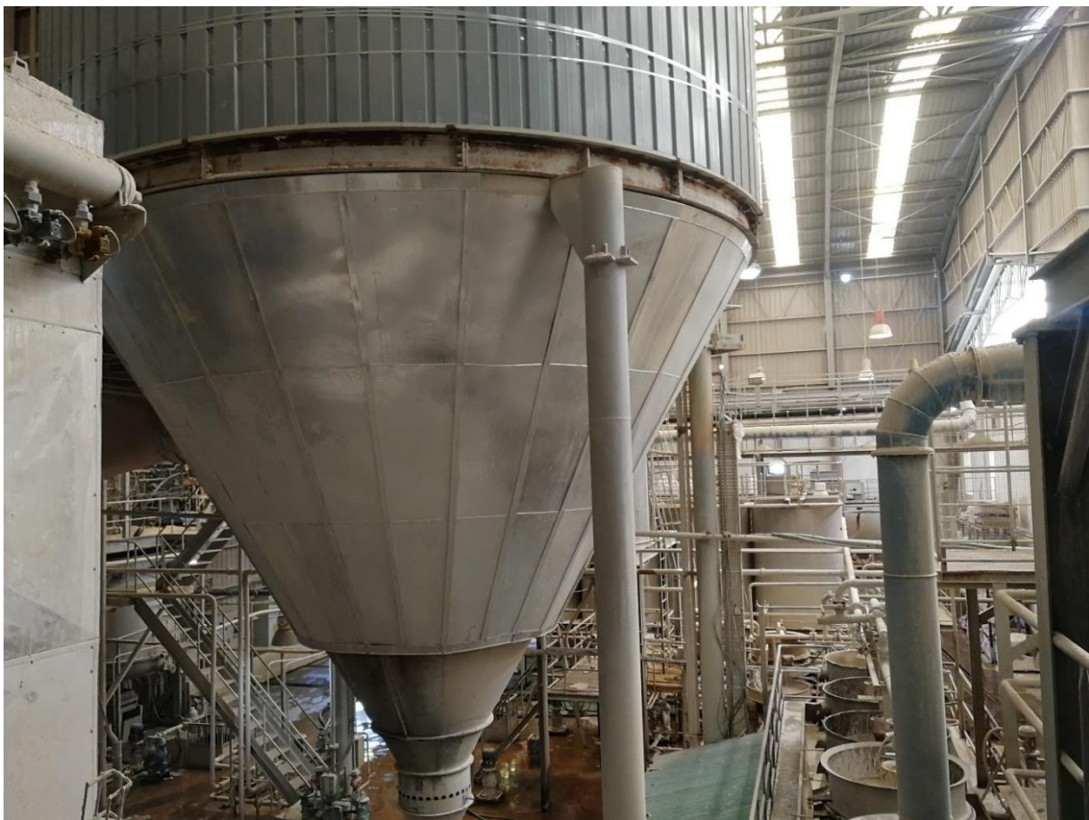
Figura 1.3 - Visão geral da unidade de preparação de pasta
